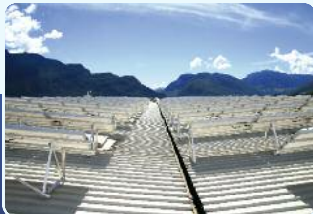
Impianti fotovoltaici per il Consorzio Melinda (TN) per complessivi 4 MW
